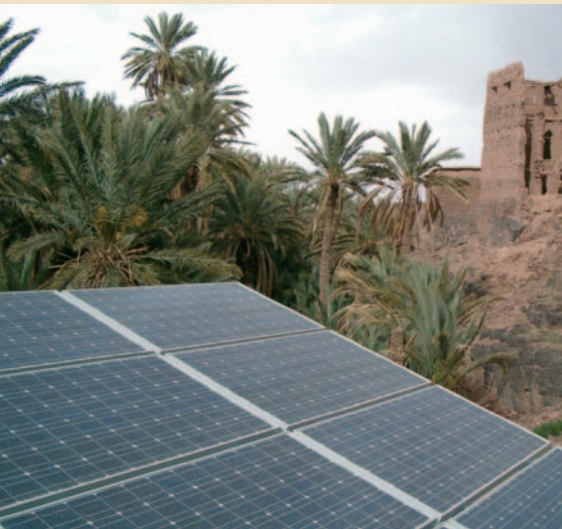
→ Figura 4. Instalación fotovoltaica en un proyecto de electrificación rural en Marruecos.
